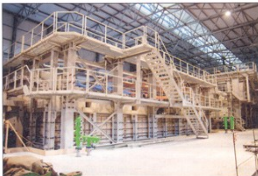
Bild 4: Komplette Glasschmelzwanne vor der Inbetriebnahme.
